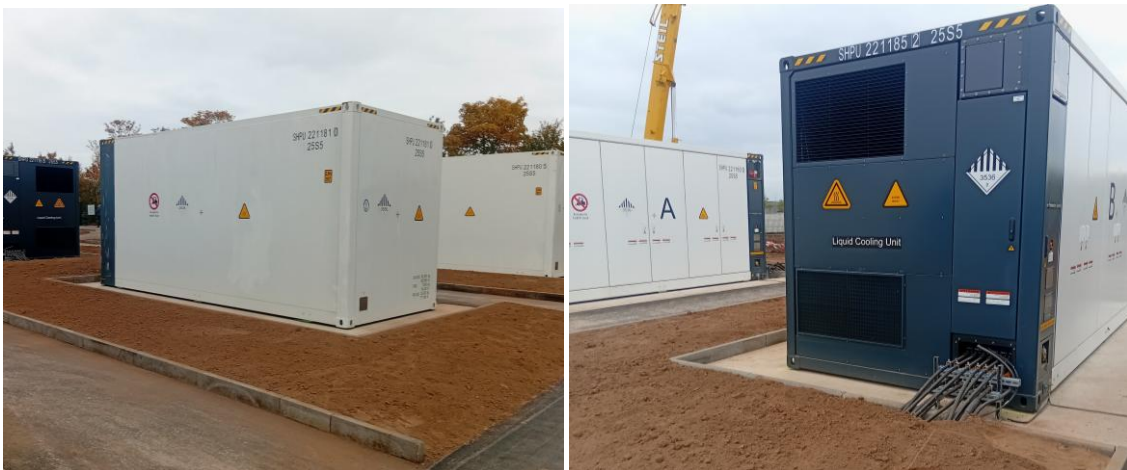
Abb. 5: Beispielhafter Batteriespeicher als Container auf einer befestigten Bodenplatte
